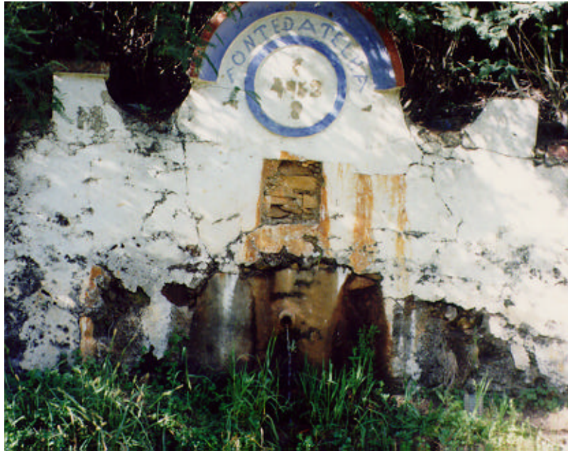
Figura 5 - Aspecto deteriorado de uma das fontes da Serra de Ossa.
