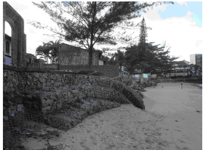
Figura 13. Processo de erosão costeira na Praia das Tartarugas. Observe a construção de uma estrutura de enrocamento em processo de solapamento após uma tempestade ocorrida em agosto de 2008 (Rio das Ostras, Estado do Rio de Janeiro).
