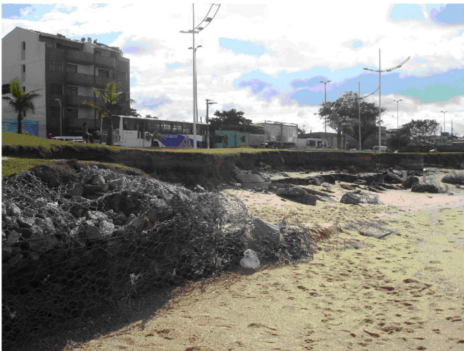
Figura 12. Área adjacente ao perfil “G”. Detalhe do trecho em processo erosivo acelerado, Rio das Ostras.
