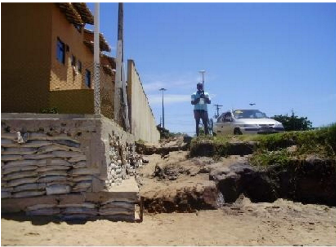
Figura 10. Construção de muro de arrimo (proteção costeira). Observe processo de erosão costeira na extremidade do empreendimento.
