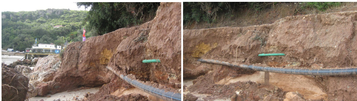
Figura 19 – Erosão do aterro construído para dar acesso à zona do Creiro, tendo ficado exposta a canalização da água (Blog a-sul. 26 Outubro 2010).
