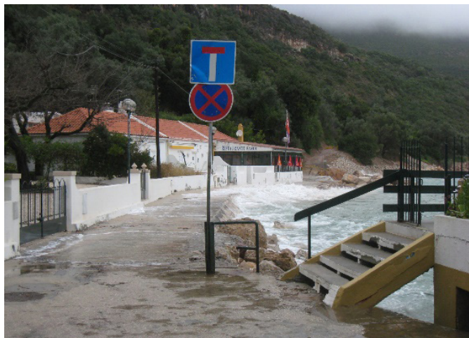
Figura 17 – Caminho que liga o restaurante “O Galeão” ao restaurante “O Farol”. Na preia-mar o mar atinge a base da estrutura de proteção e, durante os temporais, é comum a água galgar a infra-estrutura, pondo em causa a integridade da mesma e das construções aí existentes (19/2/2011) (Tailsfromportugal.wordpress.com, 24/2/2011).
