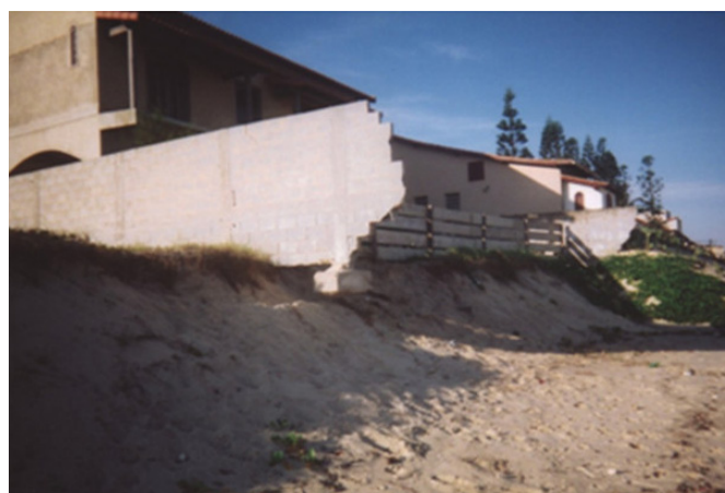
Figura 13 - Praia de Ponta Negra após a ressaca de maio de 2001 mostrando a destruição total da Avenida Litorânea e do muro de uma casa. (Foto: Flavia Lins de Barros).
