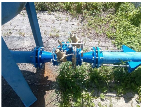
Figura 1 – Válvula antecipadora de onda instalada
