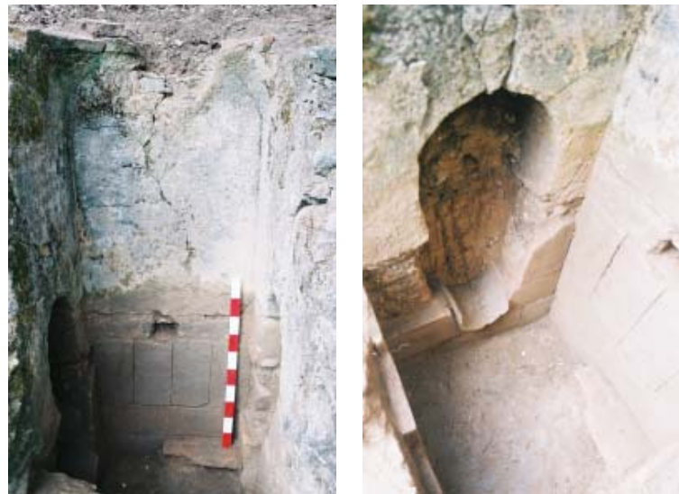
Fig. 15 – Aqueduto seiscentista. Vistas de caixa de visita e de decantação com a abóbada derruída (A. Bairinhas, 2005); um pouco a montante da caixa representada na Fig. 16.
