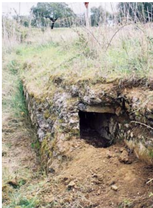
Fig. 13 – Aqueduto seiscentista. Trecho remanescente junto do atravessamento da estrada Évora-Arraiolos, notando-se cascão de suporte da cobertura.
