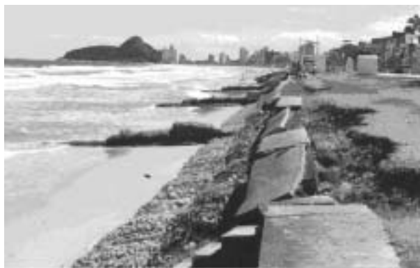
Figura 3: Porção norte da Praia Brava de Caiobá, com muros de gabiões destruídos pelas ondas.
