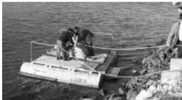
Figura 2 – Fase da instalação do protótipo do cabo de fibra óptica no canal de Mira.
