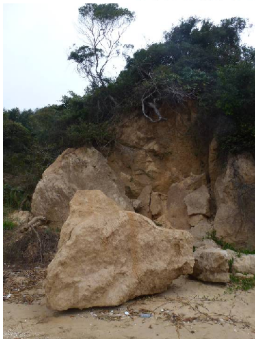
Figura 4 – Blocos acumulados na base das arribas (a Sul do Hotel Galery)
