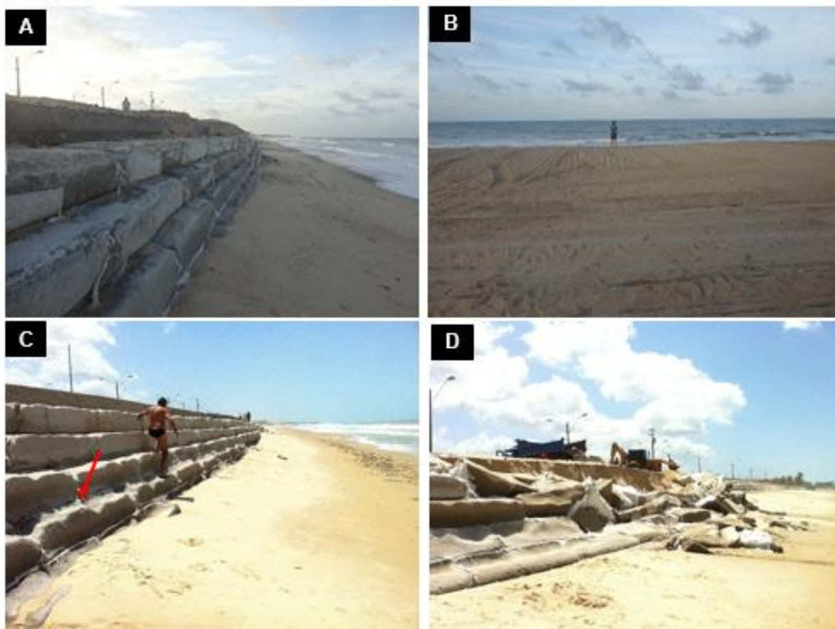
Figura 4. Imagens do segundo momento em que a obra foi colapsada. A) e B) A estrutura em fevereiro/13 estava com apenas três degraus expostos e o aterro hidráulico recomposto e aparentemente robusto; C) A seta vermelha indica os degraus modelados pela energia das ondas, dificultando o acesso do banhista à praia; D) Imagem da estrutura colapsada em maio/12.
