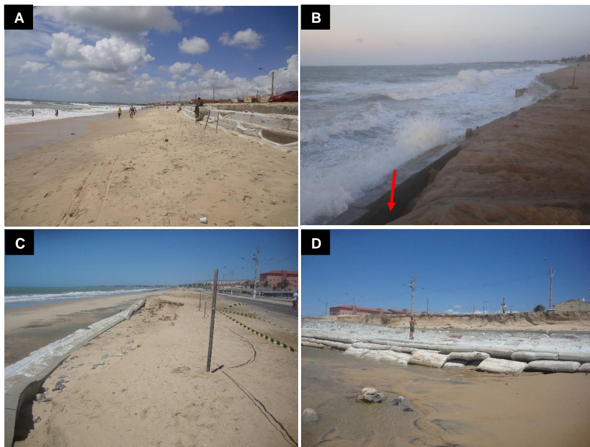
Figura 3. Imagens que evidenciam o antes, o durante e o depois do primeiro episódio de colapsamento da estrutura de proteção. A) Na foto do dia 1 de maio/12, antes da ressaca do mar, é possível observar que apenas três degraus estão descobertos; B) No dia 7 de maio, durante o evento de ressaca do mar é possível observar a fuga de material por trás da viga de coroamento indicado na seta vermelha; C) e D) Imagens dia seguinte ao evento, em que a estrutura foi danificada.
