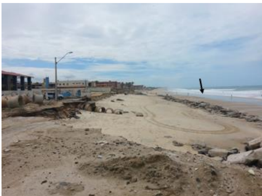
Figura 5. Destruição das estruturas urbanas na orla da Praia do Icaraí em janeiro/15. A seta indica as ruínas do dissipador de energia.
