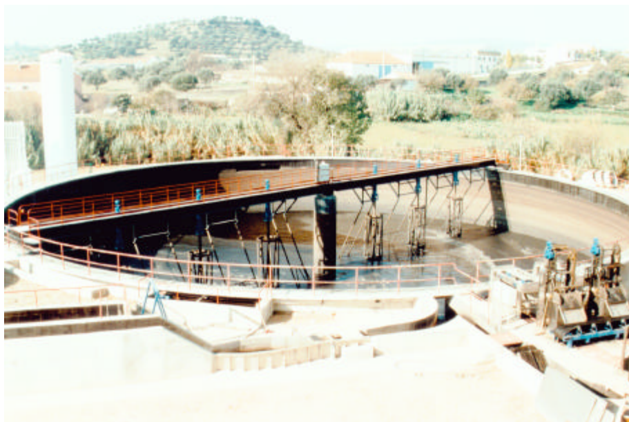
Figura 1 – Tanque de equalização
