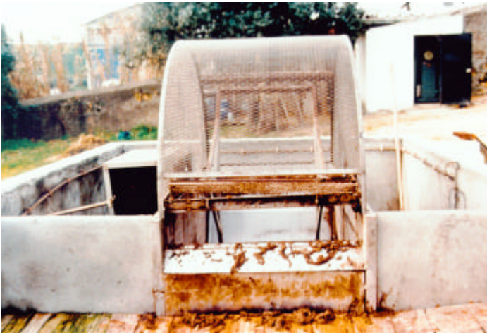
Figura 4 – Estação de pré-tratamento de uma unidade industrial
