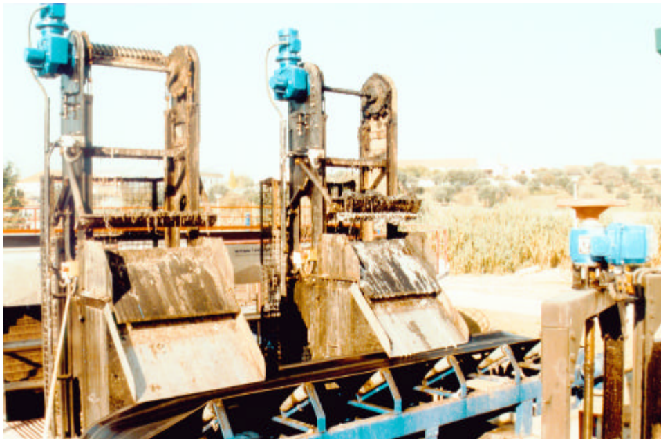
Figura 3 – Obra de entrada de uma ETAR
