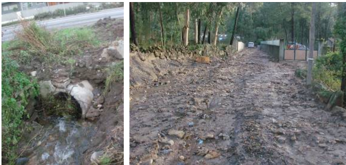
Figura 8. Várias anomalias na drenagem de águas pluviais.
