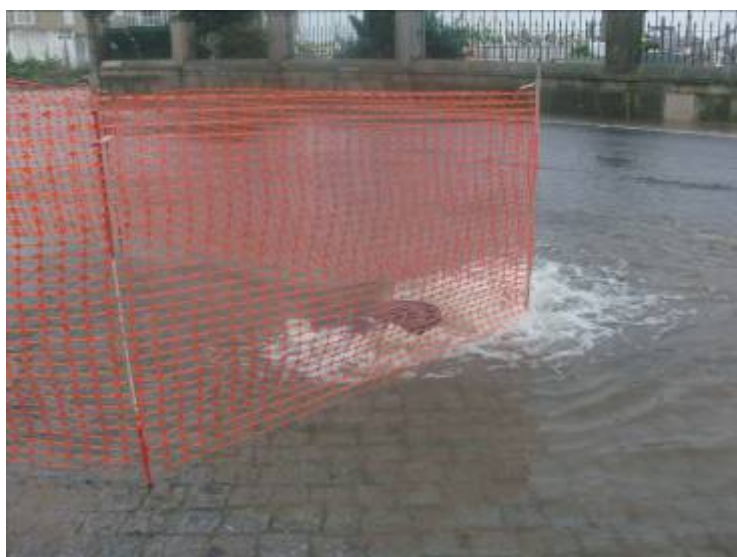
Figura 9. Anomalias na drenagem de águas pluviais.
