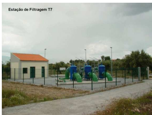
Figura 25 – Rede secundária de rega, estação de filtragem em pressão.
