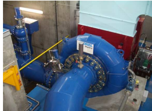
Figura 15 - Central do Meimão, turbina.
