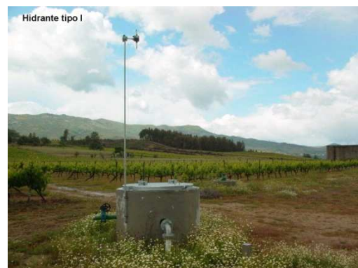
Figura 24 – Rede secundária de rega, hidrante.
