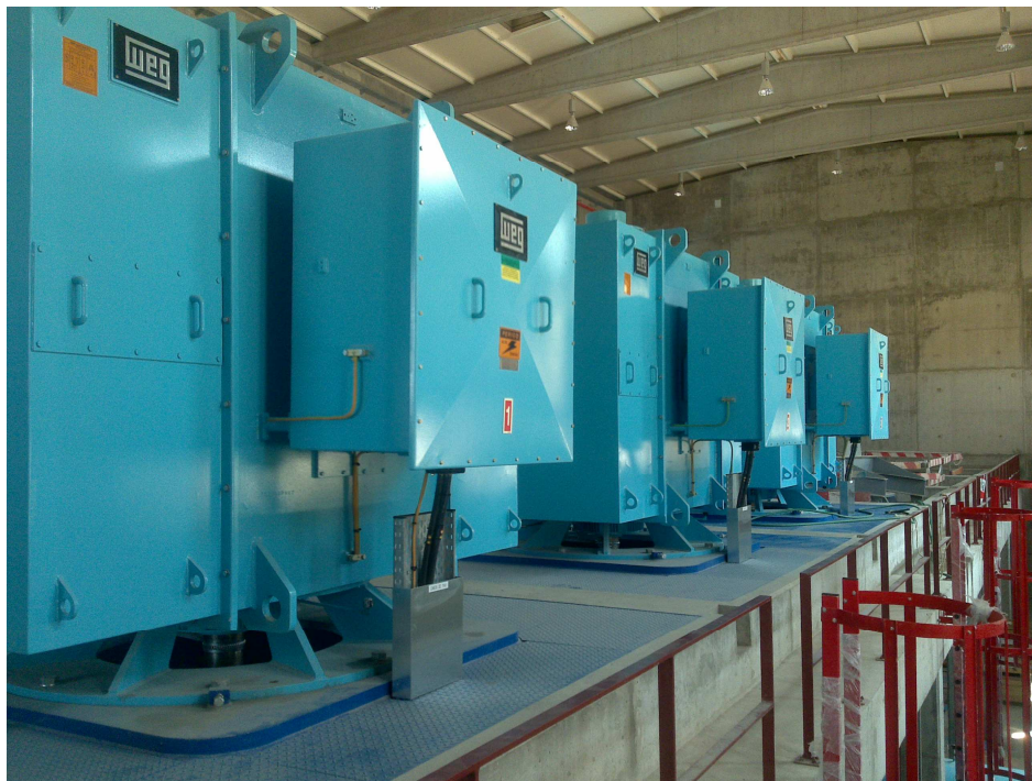
Figura 5 – Grupos electrobomba. Vista dos motores (foto cedida pelo Eng.º Morim Oliveira).
