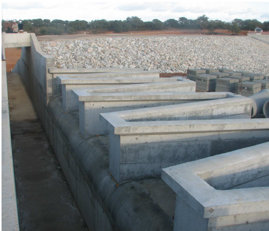
Figura 6 – Reservatório de Orada. Vista do descarregador de emergência (soleira em labirinto e canal colector) e do paramento de montante do aterro.
