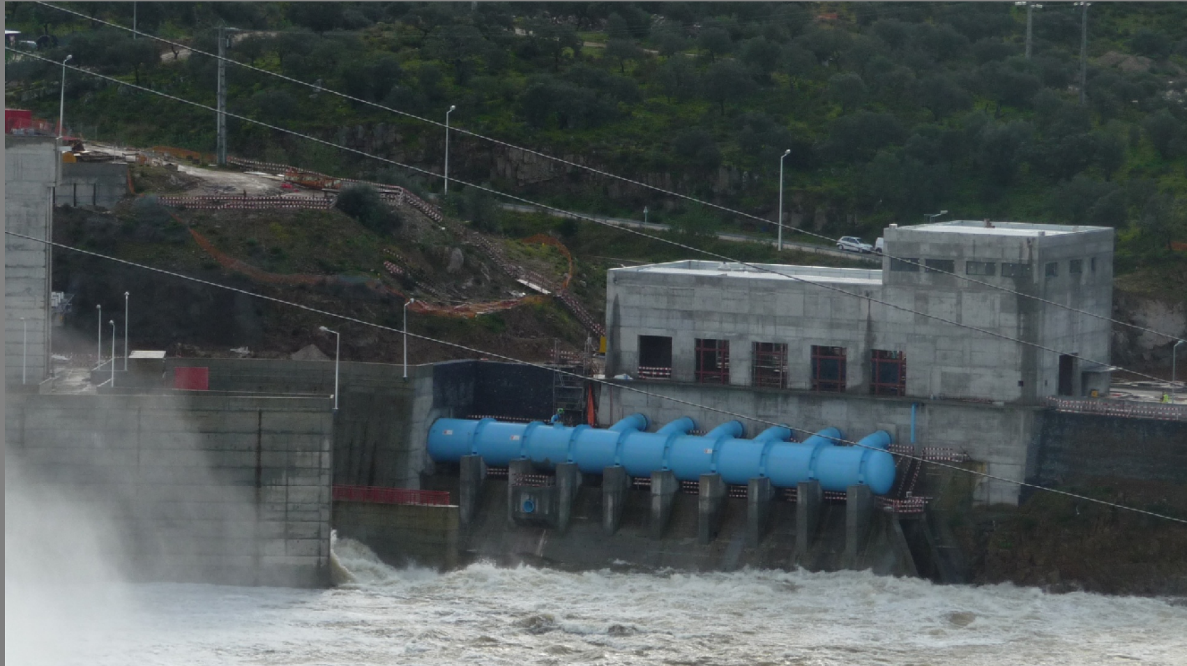
Estação elevatória do Pedrógão-Margem Esquerda. Vista a partir da margem direita.
