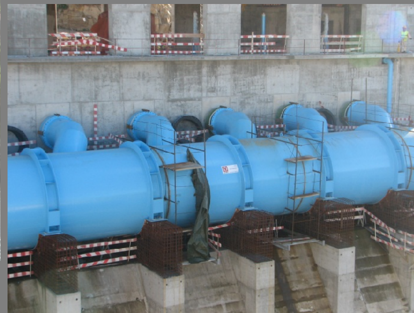
Estação elevatória do Pedrógão-Margem Esquerda. Fase de construção Vista geral e pormenor da condução de adução
