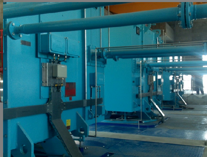
Estação elevatória do Pedrógão-Margem Esquerda. Vista dos motores
