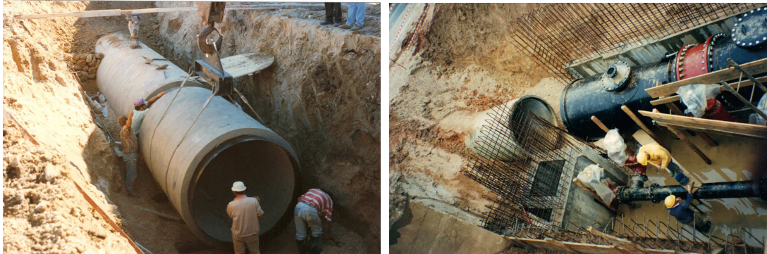
Figura 6 – Adutor Castelo de Bode – Lisboa DN 1.800 – 110.000 m
