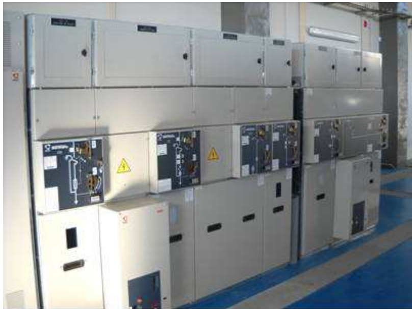
Figura 5 – Quadros de média tensão de 15kV e 6kV
