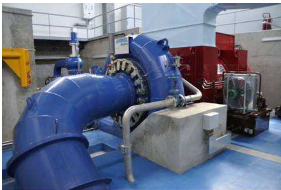
Figura 3 – Turbina e gerador
