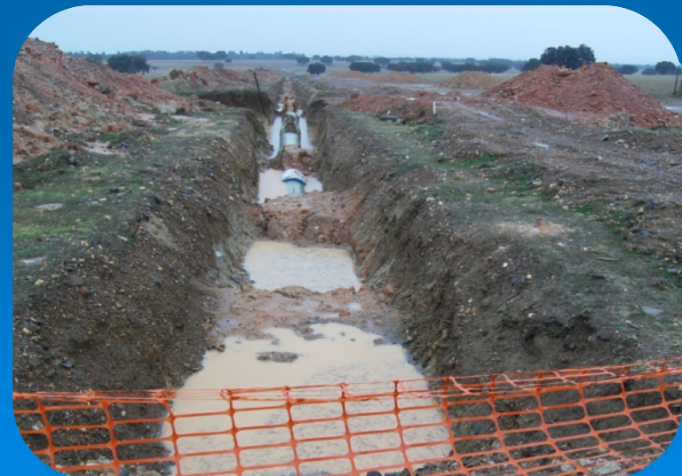
VALA INUNDADA E CONDOTA FLUTUANDO
