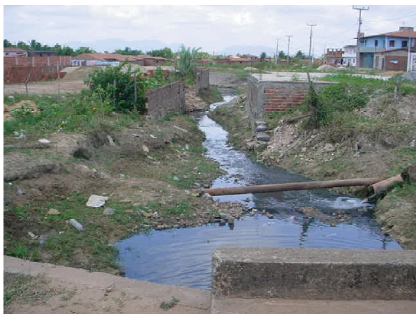
Foto 4 – Esgoto lançado em rio urbano em Fortaleza. Photo 4 - Sewer launched in urban river in Fortaleza.
