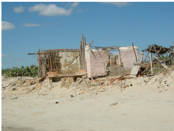
Figura 17 (a) - Ruínas de uma casa localizada nas proximidades do Perfil Manuelas II, resultado do efeito erosivo na linha de praia em 2001. Figure 17 (a) – Houses in ruin located near Manuelas II beach profile showing the erosive effect in 2001.
