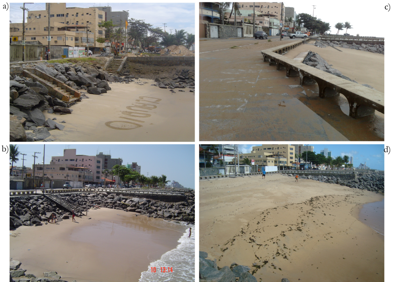
Figura 18. A expansão do aporte de sedimentos diminuiu ano a ano o desnível existente entre o calçadão e a faixa de praia no compartimento 25/26, da praia de Bairro Novo, Olinda/PE (imagens A e B).
