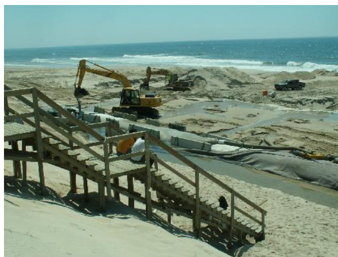
a) Tubos pré-fabricados em material geotêxtil: processos de instalação e enchimento em 14 de julho de 2008.
