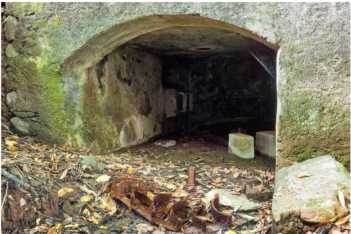
Figura 10. Moinho das Achadas da Cruz, câmara de roda, em primeiro plano rodízio de aço danificado com pás curvas duplas, segundo rodízio ao fundo, poderia ser desmontado e transportado para um museu.
