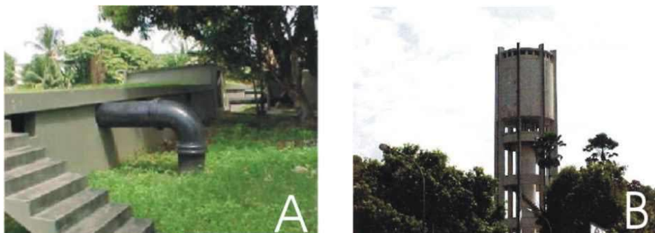
Figura 2 – entrada da tubulação de água tratada no reservatório enterrado(A) e vista externa do reservatório elevado do 4º setor de abastecimento(B).
