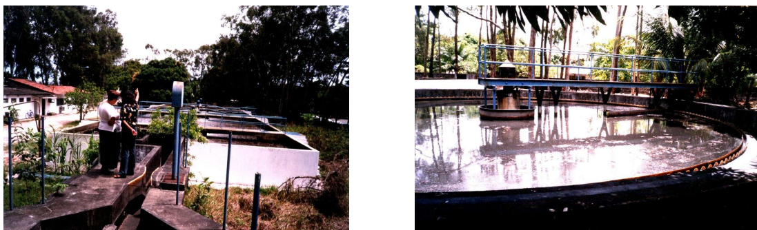
Figura 1 : Fotos da ETE Caçote (Bairro de Areias, Recife – PE) : canal de entrada com caixa de areia, seguida
