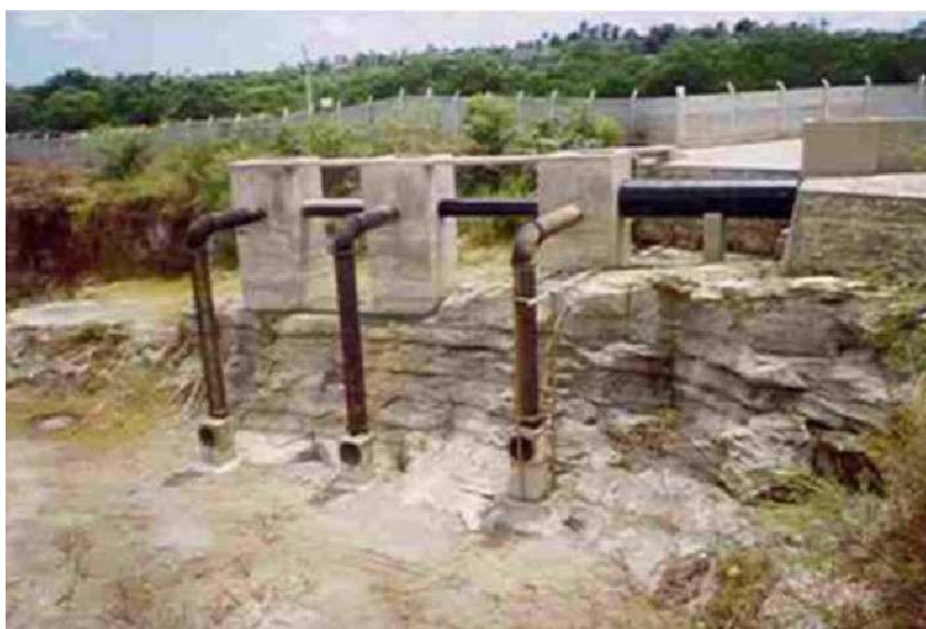
Figura 2: Detalhe da tubulação de entrada do afluente da lagoa anaeróbia da ETE do Roger.
