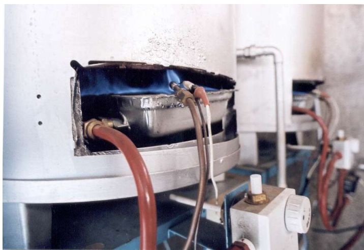
Figura 04 - Detalhe da queima do biogás dentro da caldeira.
