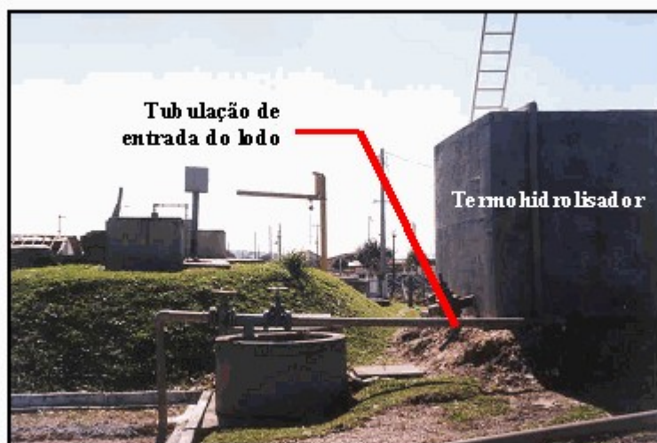
Figura 02 – Termohidrolisador de lodo mostrando em detalhe a tubulação de entrada e retorno do lodo.
