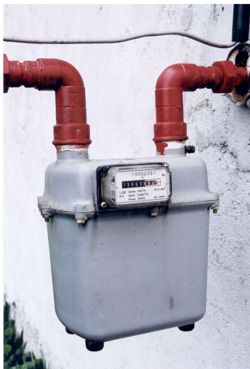
Figura 05 - Medidor para leitura de biogás e acompanhamento da produção do biogás no medidor instalado na saída do RALF.
