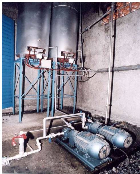
Figura 03 - Caldeiras de aquecimento de óleo através do biogás e bombas de circulação
