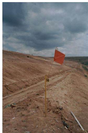
Figura 4 – Medidor de recalques superficiais instalado e identificado
