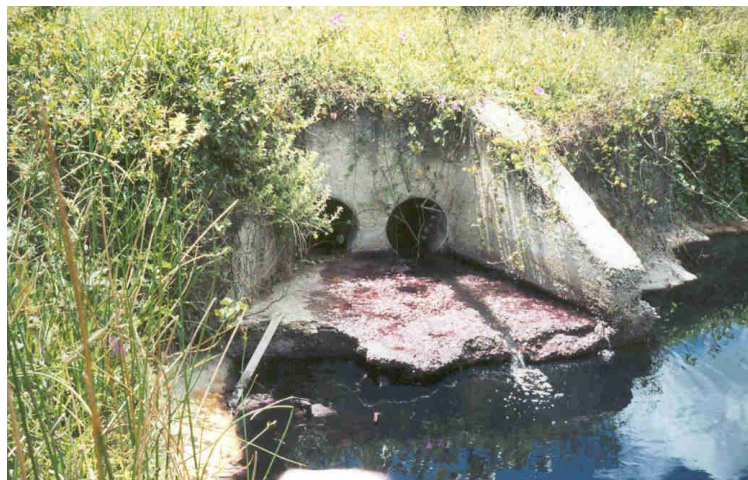
Figura 4. Lançamento de esgoto industrial no Rio Golandim não proveniente da Estação de Elevação de Efluentes (EEE).
