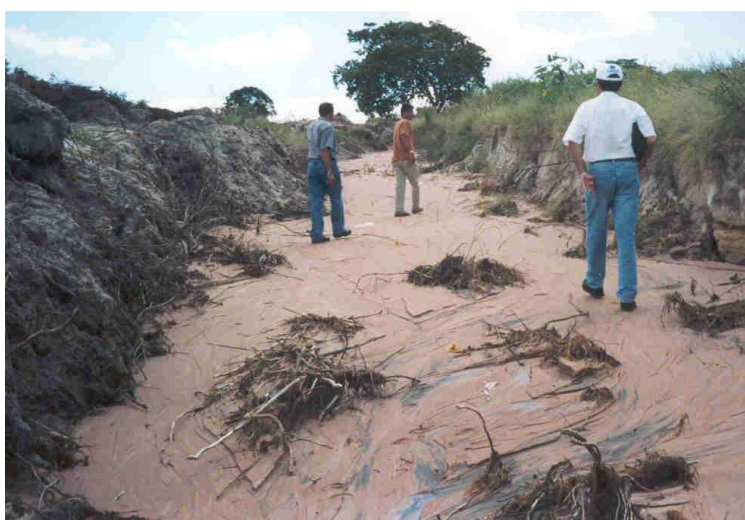
Figura 6. Erosão causada pelo rompimento do "Stand Pipe" e acentuada pelas chuvas.
