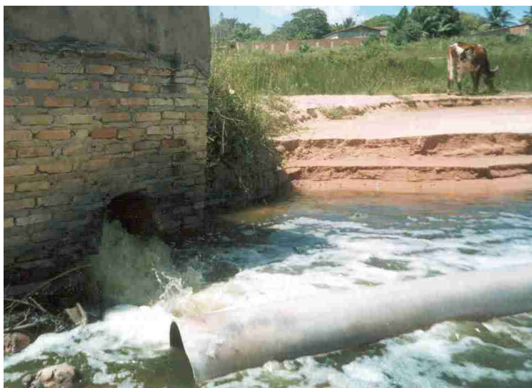
Figura 5. Rompimento do emissário na caixa de passagem (ao fundo observa-se uma grande quantidade de areia devido o processo de erosão no local)
