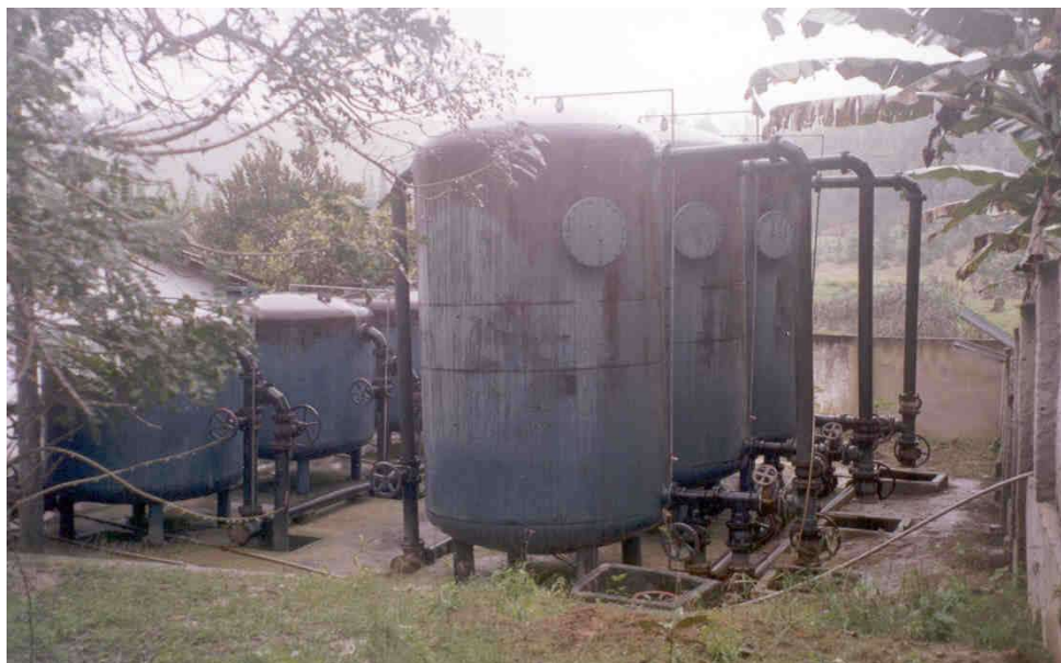
FIGURA 01: Estação de Tratamento de Água de Barra de Guabiraba. À direita, filtros ascendentes e à esquerda filtros descendentes.
